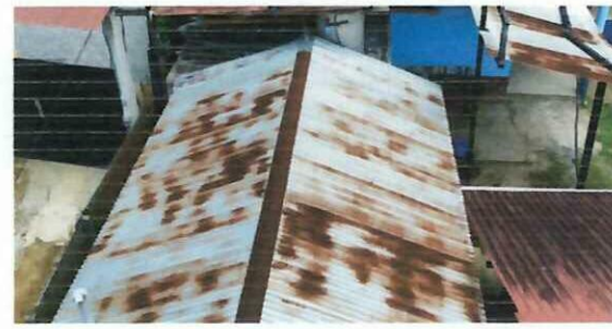
Foto 4: Cambio de láminas y capote acanaladas oxidadas por láminas troqueladas color rojo, calibre 26 mm.
